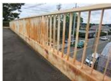
地覆の防食機能の劣化
