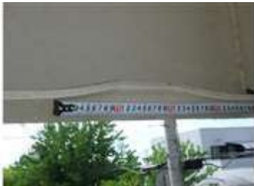
桁の変形・欠損
