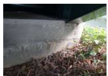
橋台のひびわれ
