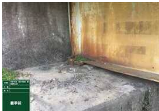
支承部の腐食、沓座モルタルの断面欠損
