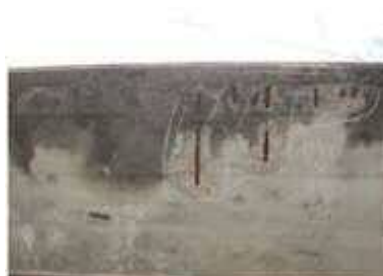
床版の鉄筋露出
