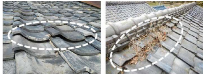
瓦にずれや浮き上がりが生じている例
