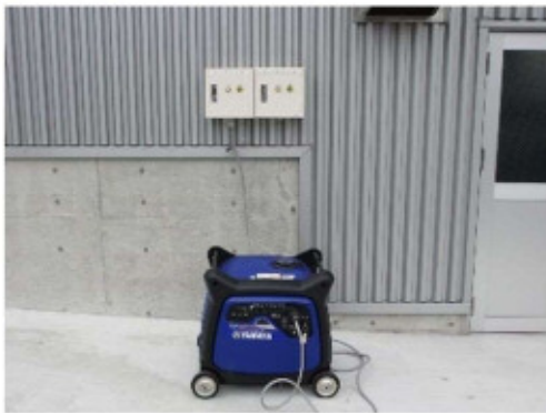
避難所非常用電源
