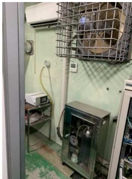
写真5 平場局舎内の状況
