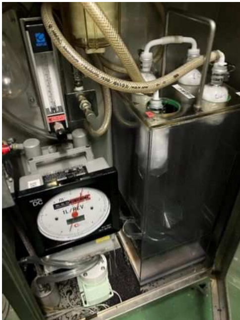
写真1 カラムの破損状況
