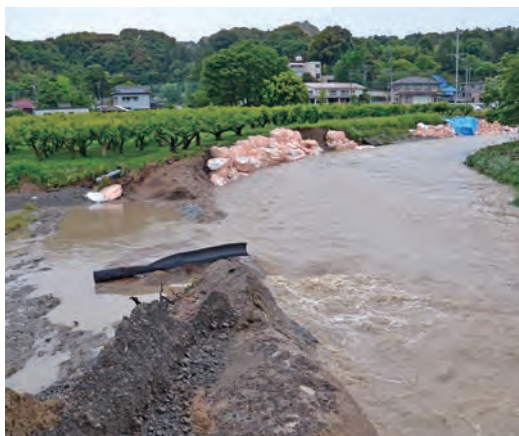
6月2日 決壊した敷地川堤防
