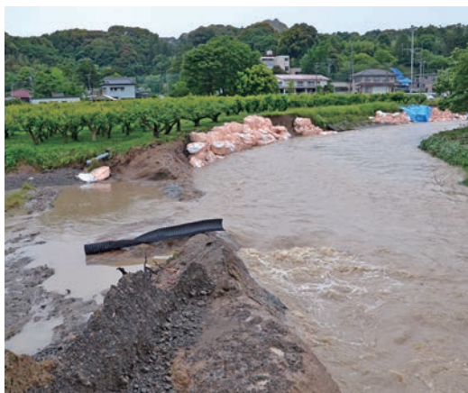
6月2日 決壊した敷地川堤防
