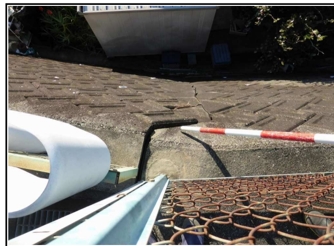
6 末端擁壁 亀裂および孕み出し
