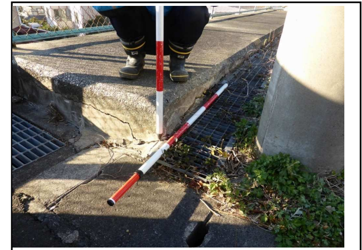
4 末端擁壁 背後の変状 沈下 亀裂
