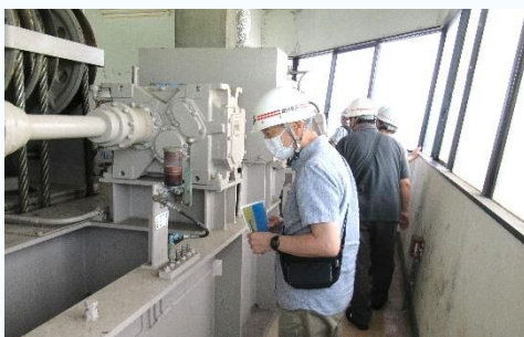
仿僧川水門内部のゲート開閉のワイヤー
