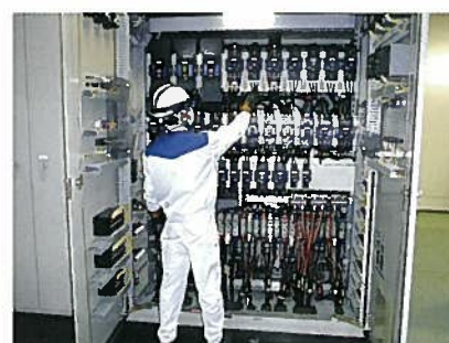
動力盤を点検中
