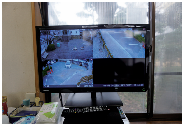
写真 46 防犯カメラ（屋内モニター）
