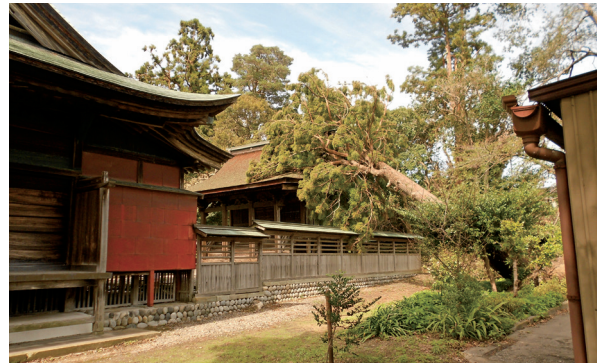
写真 92 淡海国玉神社本殿の倒木 平成 23 年
