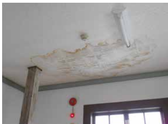
平成 24 年度修繕工事前（天井雨漏り）
