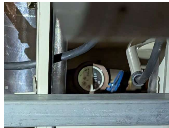
既設減算メーター 40 A 検満期限：令和 8 年 11 月
